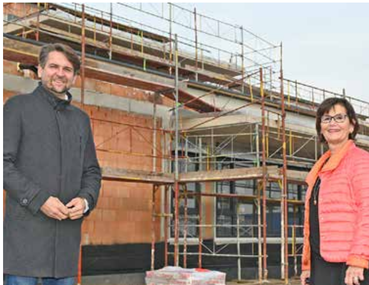
Stadträtin Margarete Josseck-Herd und Stadtrat Peter Lehner überzeugen sich an Ort und Stelle vom planmäßigen Baufortschritt.
