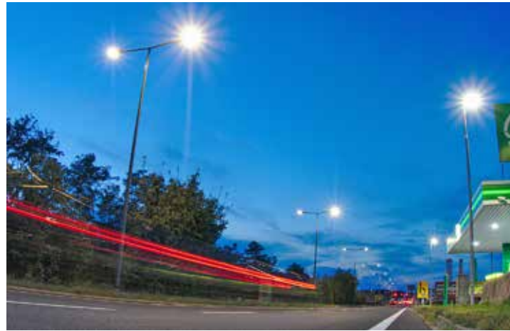
2020 wurde die – von der Stadt koordinierte und vom Land finanzierte – topmoderne Beleuchtung der Osttangente fertig.
